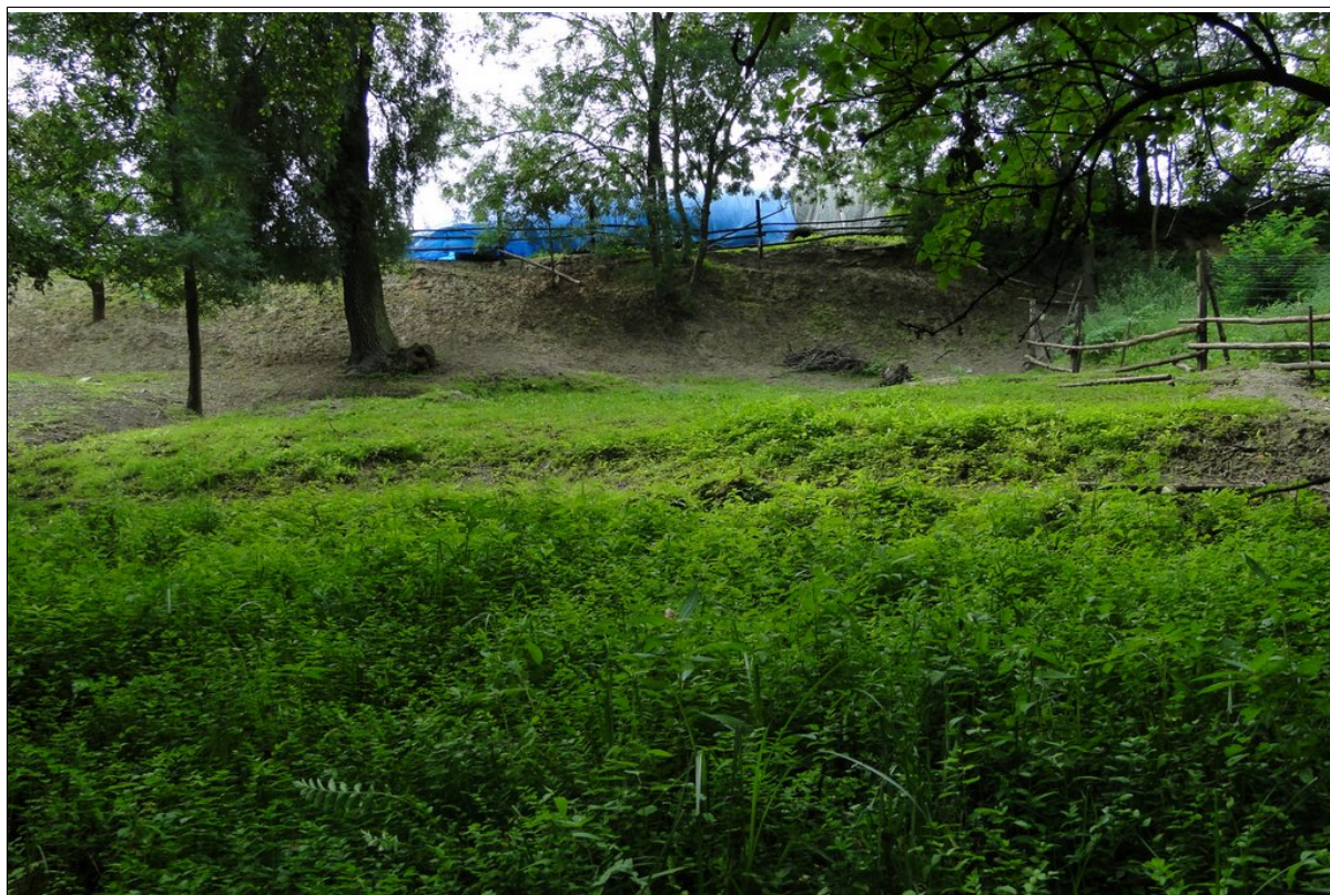
Widok na skarpe główną osuwiska oraz koluwia porośnięte trawą.
