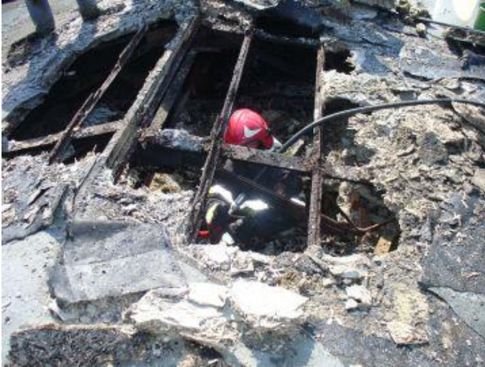
Zdjęcie 20 Uszkodzona w wyniku pożaru konstrukcja dachu kurnika. Strażak dogasza konstrukcję. Fot. archiwum KP PSP w Inowrocławiu.
