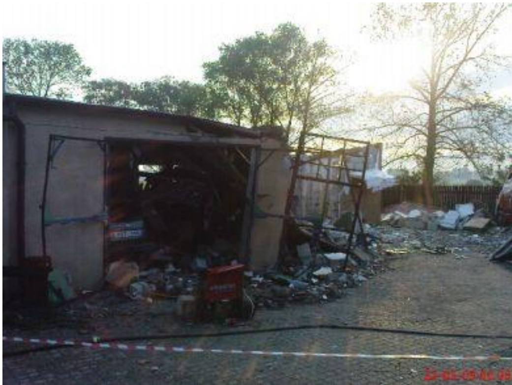
Zdjęcie 15 Widok na częściowo zawalony budynek warsztatu samochodowego i uszkodzone z tego powodu pojazdy w jego wnętrzu, które blokowały możliwość przeszukania gruzowiska dla odnalezienia ewentualnych osób poszkodowanych. Fot. archiwum KP PSP w Inowrocławiu.
