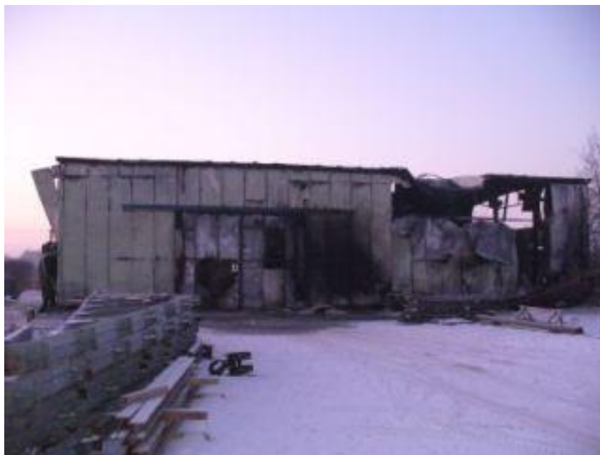
Zdjęcie 2 Uszkodzona w wyniku pożaru hala produkcyjna przedsiębiorstwa DĄB-BUD w Dąbrowie Biskupiej. Fot. archiwum KPPSP w Inowrocławiu.
