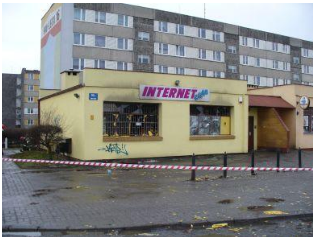
Zdjęcie 4 Widoczne uszkodzenie okien budynku i odłamki rozrzucone na chodniku. Fot. archiwum KPPSP w Inowrocławiu.
