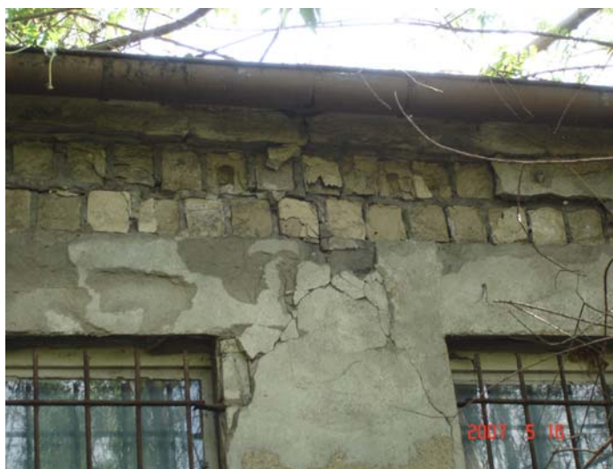
Elewacja boczna – podłużna – zarysowanie gzymsu
