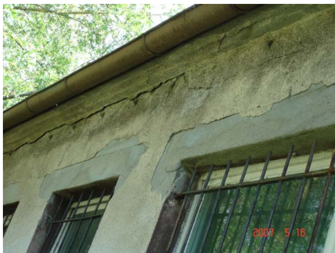
Elewacja boczna – podłużna – zarysowanie gzymsu – wysunięcie ściany
