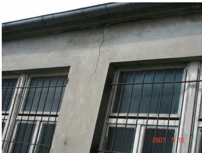
Elewacja boczna – podłużna – zarysowanie filarka
