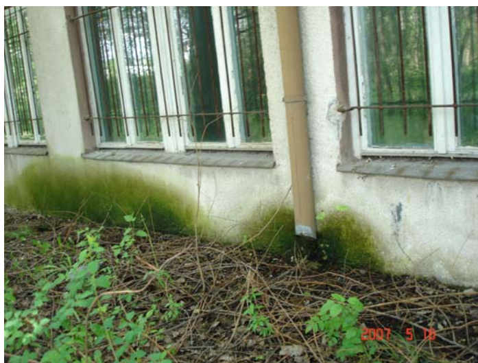
Elewacja boczna – podłużna – zawilgocenie ściany, niewłaściwe odprowadzenie wody z dachu
