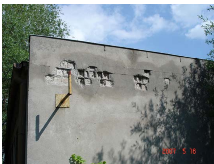
Elewacja tylna – szczytowa – zarysowanie ściany
