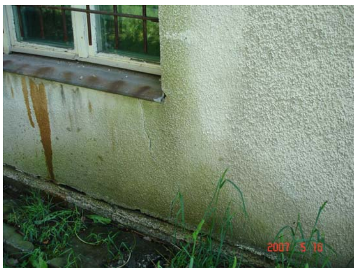
Elewacja boczna – podłużna – zarysowanie i zawilgocenie ściany
